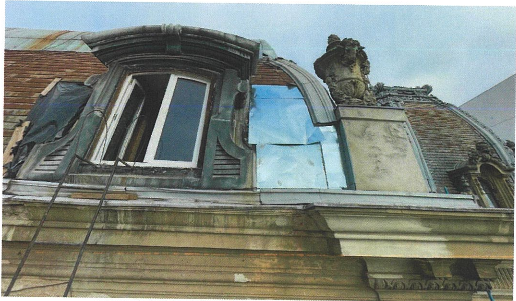
Foto 35. Acestea prezintă degradări sub formă de halouri, datorate infiltrațiilor apelor pluviale, cauzate de degradarea sortului de tablă ce protejează cornișa.
