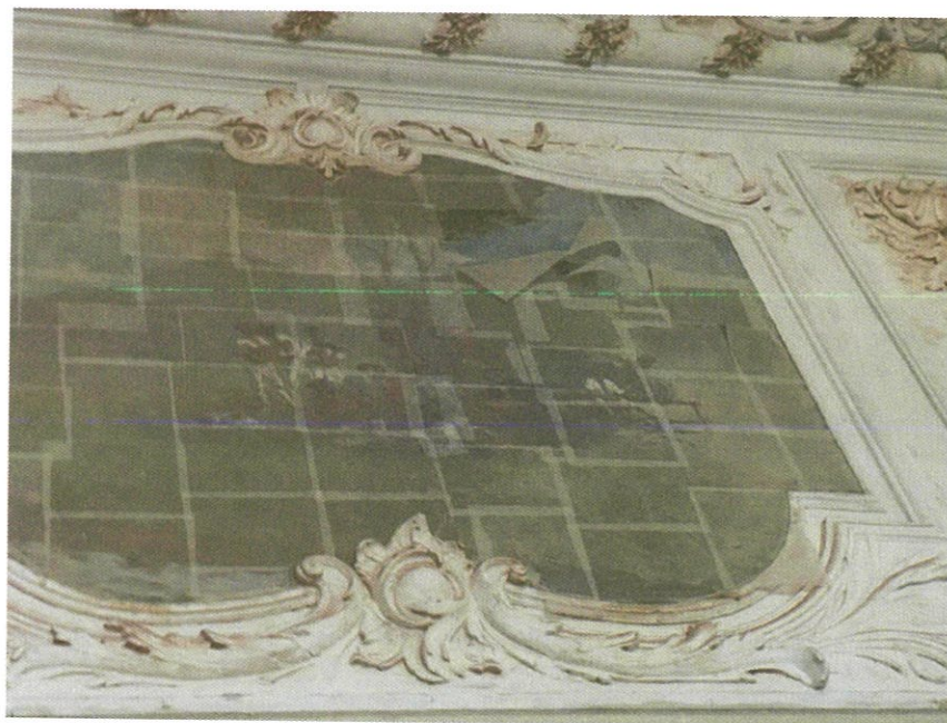
Foto 04. Foița japoneză prezintă desprinderi locale și pete cauzate de umiditate (datorate modificării microclimatului odată cu realizarea intervențiilor de turnare a planșeului din beton din zona planșeului de la parter).
