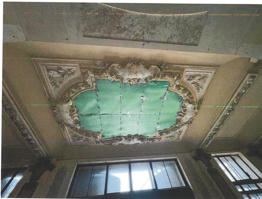
Foto 03. P 18, Aula - În zona cupolei aulei, picturile murale (unde s-au realizat intervenții de conservare-restaurare și au fost vernisate), sunt acoperite cu folie expandată (PEE) prinse pe margine cu bandă adezivă.
