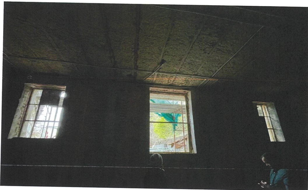
Foto 41. Golurile ferestrelor nu prezintă închideri etanșe, existând zone cu risc de pătrundere a apelor pluviale și a păsărilor.
