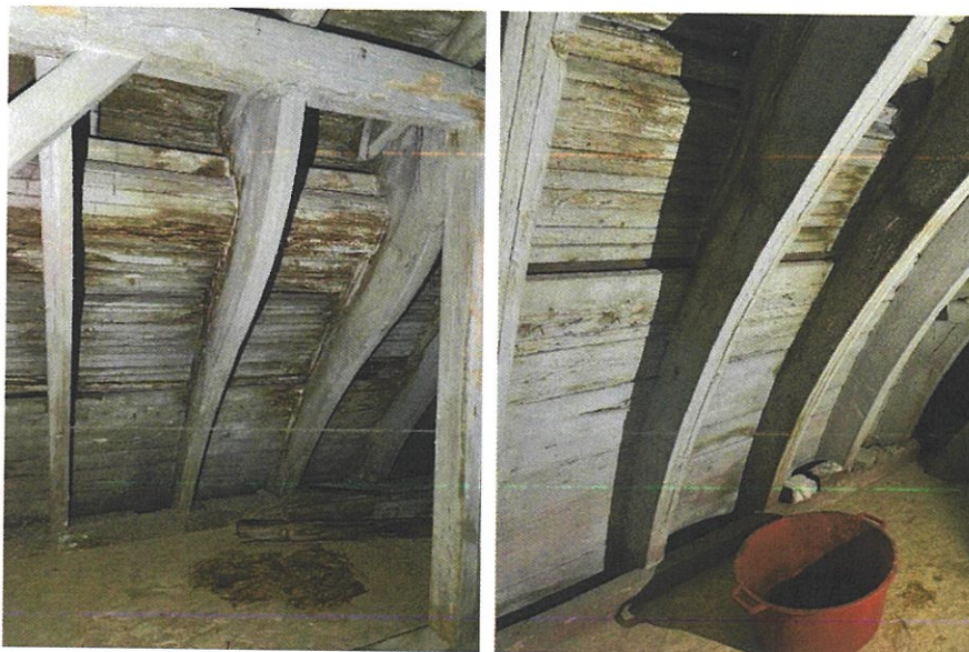
Foto 34. Infiltrațiile acoperișului afectează structura de lemn a șarpantei
