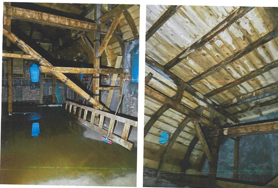
Foto 40. Infiltrații ale apelor pluviale de la nivelul acoperișului. Acestea ajung pe placa de beton armat, realizată la consolidările din 2023 de la etajul 1, precum și la nivelul parterului.
