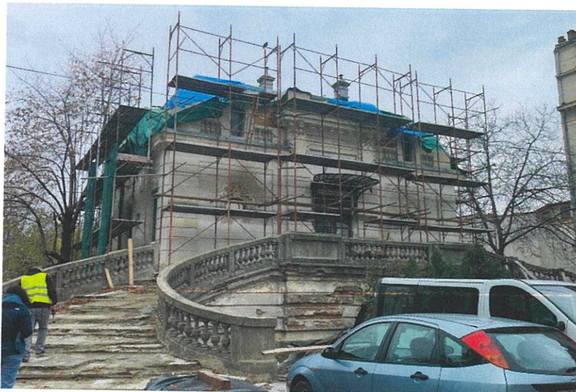
Foto 37. Degradări ale tencuielilor sub formă de halouri și pete datorate infiltrațiilor apelor pluviale, cauzate de degradarea sortului de tablă ce protejează cornișa.
