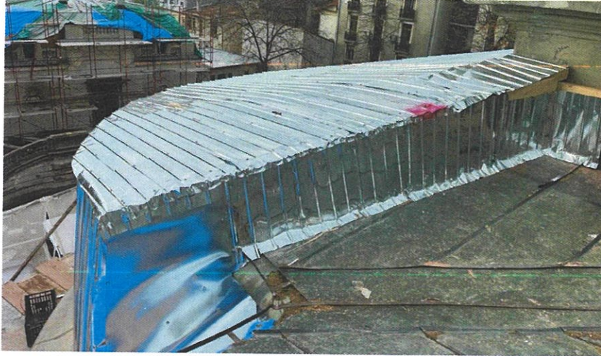
Foto 31. Învelitoarea se află în stadiul anterior lucrărilor de execuție, prezentând însă lucrări provizorii de acoperire pe anumite zone.
